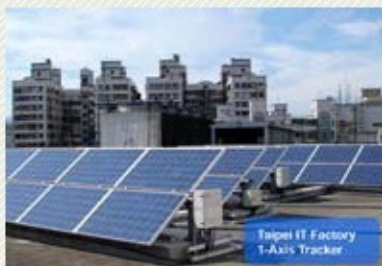
台湾で実績のあるメーカーによる追尾架台 ※写真が裏面より1軸
